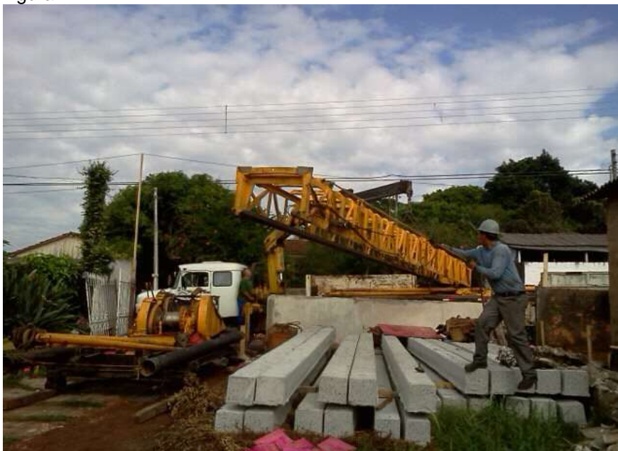
Pilares de concreto para a construção do Prédio Flor de Liz. Itararé SP
