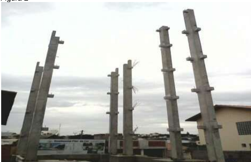
Levantamento dos pilares para a construção do Prédio Flor de Liz. Itararé S
