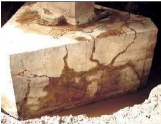
Figura 5- Deterioração causada pela reação álcali-agregado
