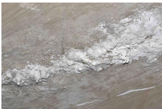
Figura 4- Eflorescências decorrentes da lixiviação do concreto
