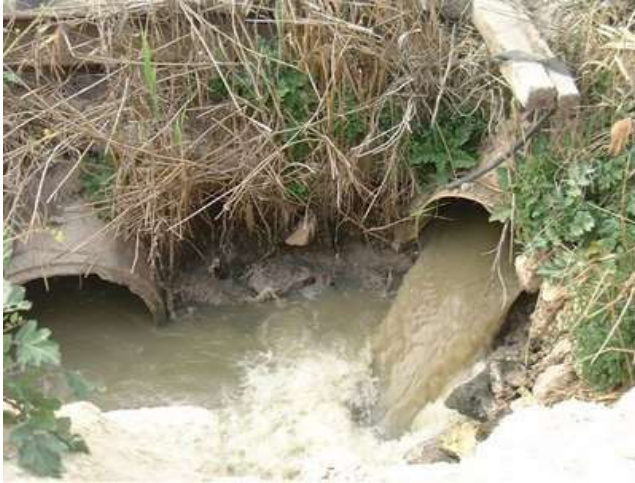
Esgoto, sem tratamento na água sendo jogado no rio
