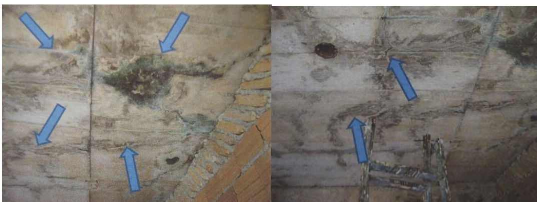
Figura 8: Fotos do 6º andar, a laje da cobertura apresenta alguns pontos de infiltração, eflorêscencia do concreto por lixiviação. Foto (08/12/18).
