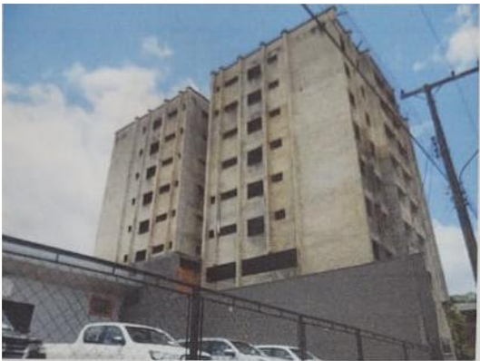
Figura 2: foto da fachada lateral esquerda do prédio apresenta uma parte rebocada e uma parte chapiscada, também apresenta limos e fungos, precisando de uma limpeza e sem a presença de patologias. Foto (08/12/18).
