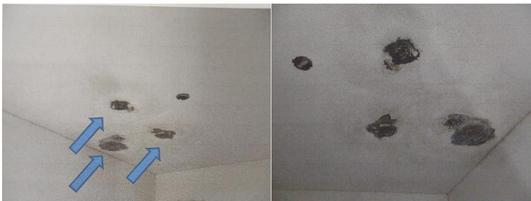
Figura 7: Fotos do 3º andar, alguns pontos isolados de infiltração. Foto (08/12/18).
