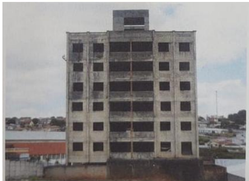
Figura 1: Foto da fachada do fundo, na imagem apresenta apenas uma parte rebocada, e parcialmente chapiscada, contendo limos e fungos, precisando de uma limpeza, não se observando a presença de nenhuma patologia de maior preocupação. Foto (08/12/18).
