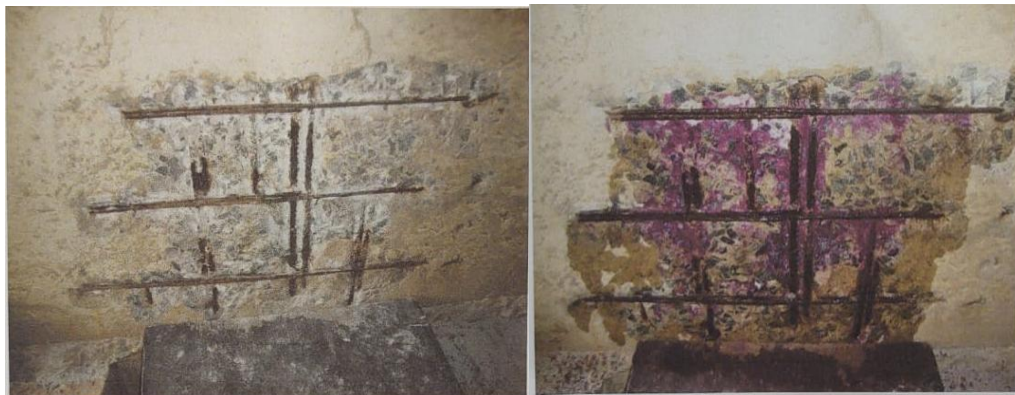
Figura 3: Fotos do andar térreo, imagem do pilar da caixa de elevador parte externa, apresenta desagregação do concreto, cobrimento insuficiente e apresentando oxidação na armadura. Foto (08/12/18).
