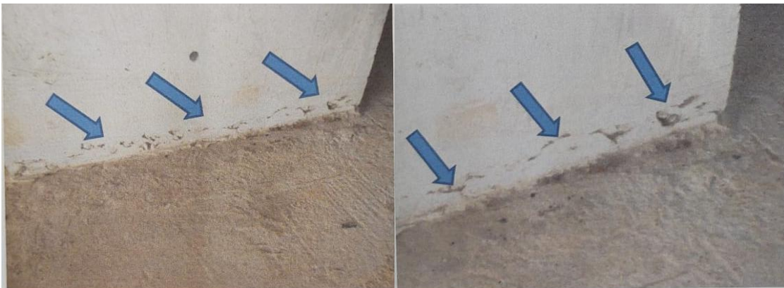
Figura 6: Fotos do andar térreo o pilar de concreto apresentam algumas bicheiras. Foto (08/12/18).
