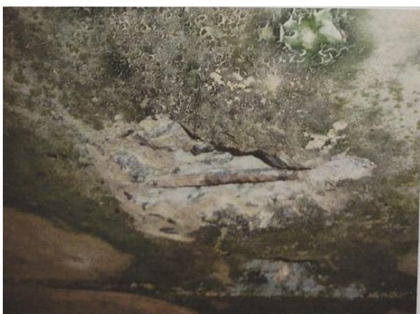
Figura 4: Foto do andar térreo apresentando ferragem exposta, com cobrimento suficiente de 2,5 cm, e a seção do aço está preservada.
