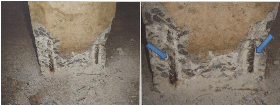
Figura 9: Fotos do térreo apresenta armadura preservada com pouca oxidação. Foto (08/12/18).
