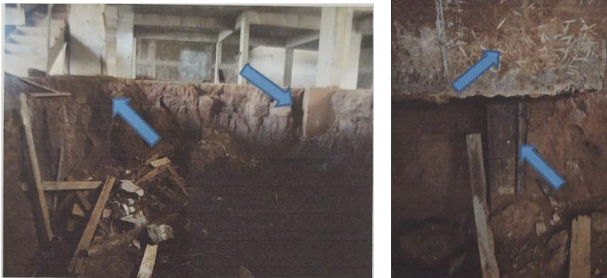
Figura 5: Fotos do subsolo, a imagem mostra que a escavação está comprometendo alguns blocos da fundação, estando as estacas aparentes. Foto (08/12/19).
