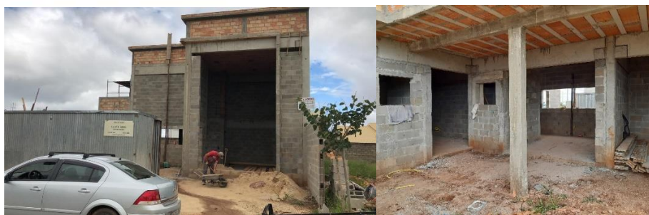
Foto 03 e foto 04 – Residência de alto padrão na cidade de Itapeva-SP ( Residencial Ouroville) Fonte: Do autor
